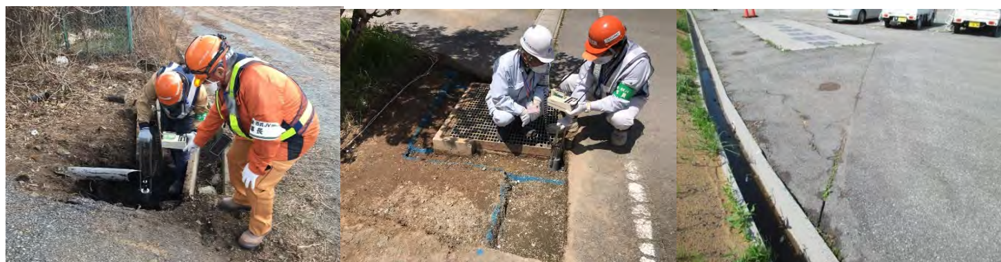
未舗装の路肩
